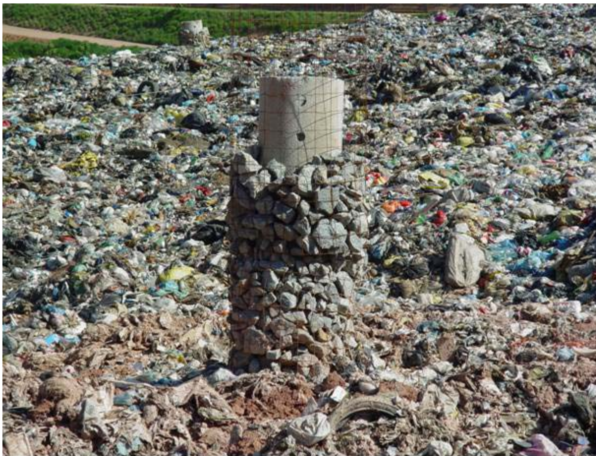
Figura 38 - Estrutura utilizada para captura do biogás no aterro sanitário da Marca Ambiental Fonte: foto enviada pela Marca Ambiental
