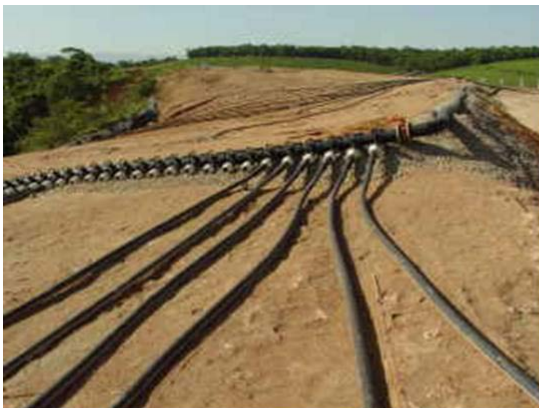
Figura 40 - Estrutura utilizada para captura do biogás no aterro sanitário da Marca Ambiental Fonte: foto enviada pela Marca Ambiental
