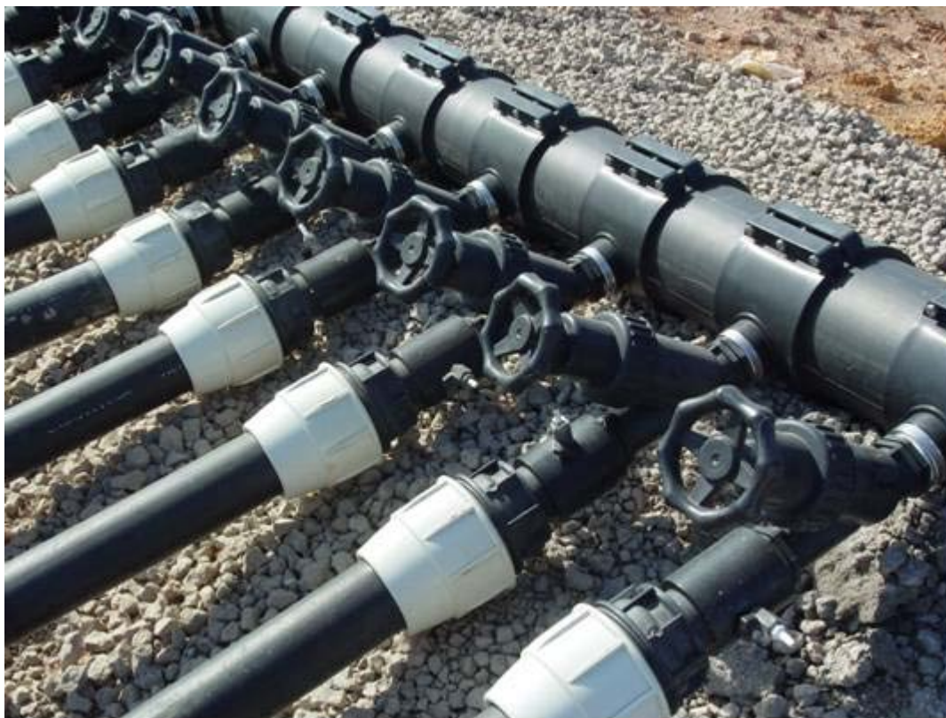
Figura 39 - Estrutura utilizada para captura do biogás no aterro sanitário da Marca Ambiental Fonte: foto enviada pela Marca Ambiental
