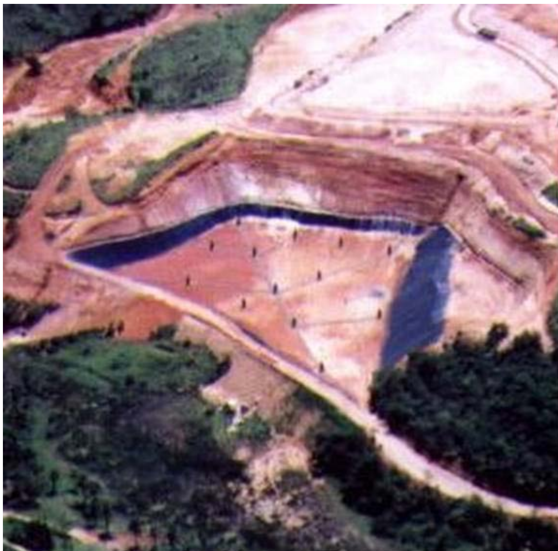
Figura 37 - Fotografia da célula 3 durante a construção do sistema de coleta de gás do aterro. Fonte: MARCA AMBIENTAL (2004)
