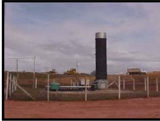
Figura 07: FLARE (Sistema de Sucção para a Queima do Biogás instalado na central de tratamento e destinação final de Resíduos da Marca Ambiental).
