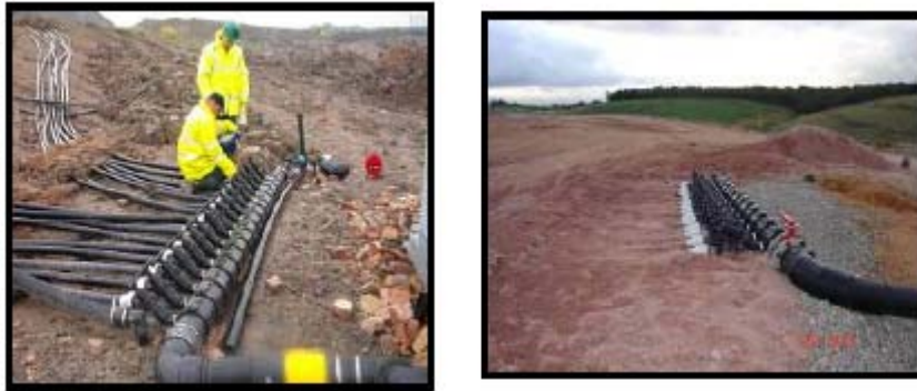
Figura 06: MAINFOALD (Sistema de Distribuição do Biogás composto de conector, válvula de controle, dreno para condensados e registro de gaveta). Fonte: Marca Ambiental 2007
