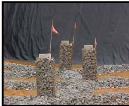
Figura 05: Drenos Verticais para a Captação do Biogás.
