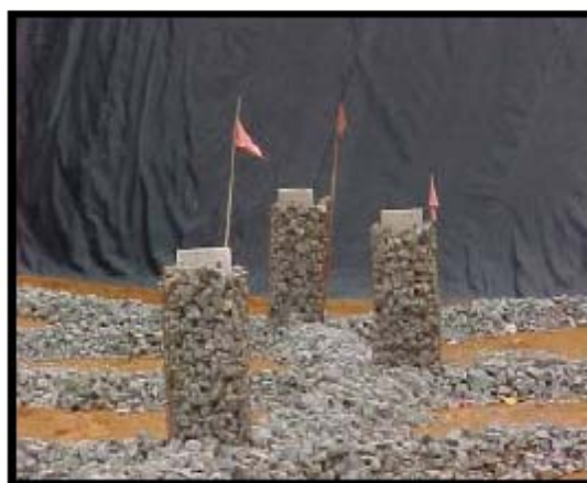
Figura 05: Drenos Verticais para a Captação do Biogás.
